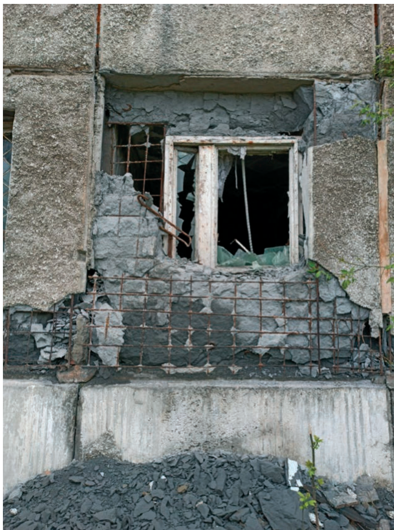
Рис. 3.15. Пример разрушения элементов конструкции здания аварийного общежития (расселенного) по адресу Советская, 176, к. 19/1
