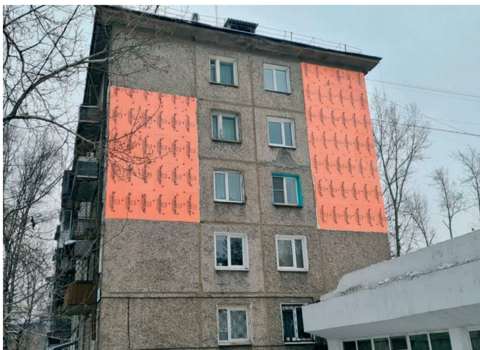
Рис. 6.4. Временное утепление в местах разрушения фасадной плиты, Депутатская, 10
