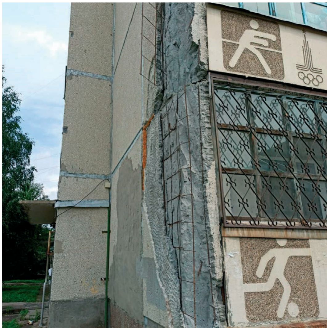
Рис. 6.2. Разрушение фасадной плиты, г. Ангарск, 85-й квартал, 24
