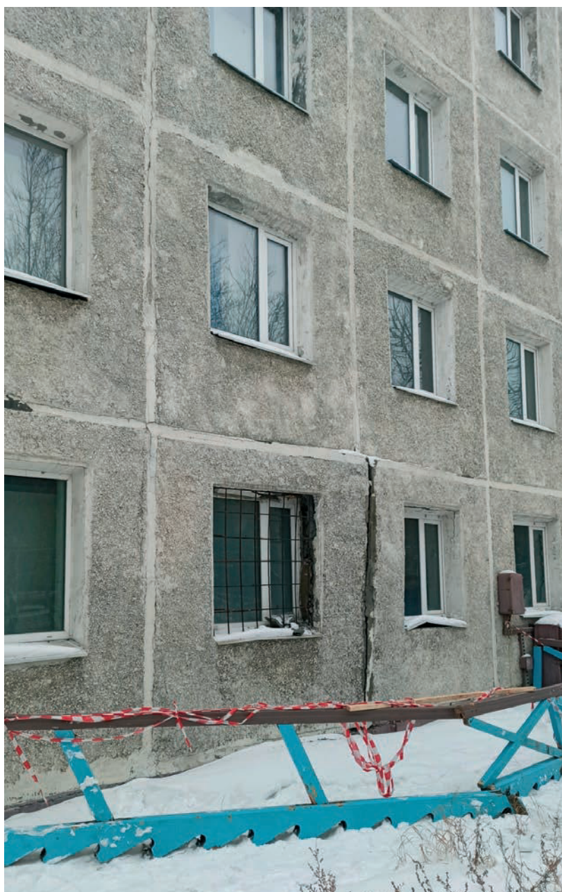
Рис. 3.17. Пример разрушения элементов конструкции здания общежития по адресу Советская, 176, к. 19/2
