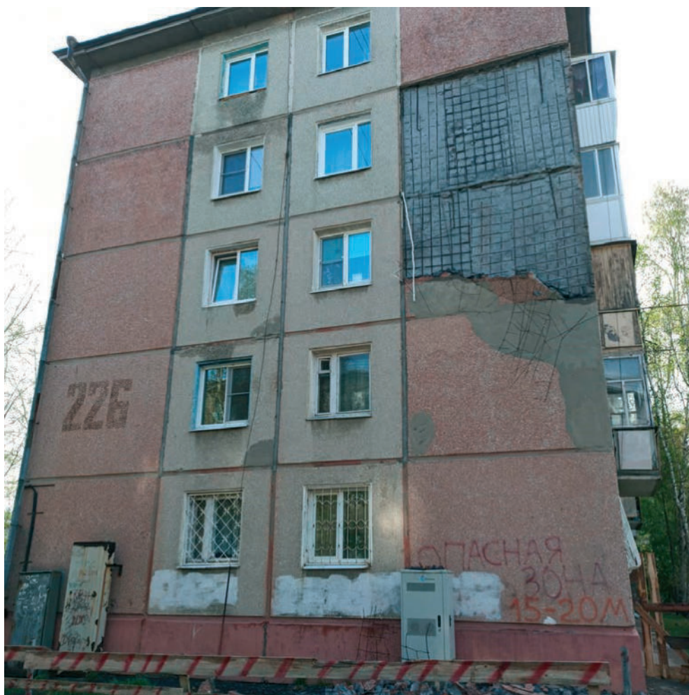
Рис. 6.3. Разрушение фасадной плиты, г. Иркутск, Баумана, 226
