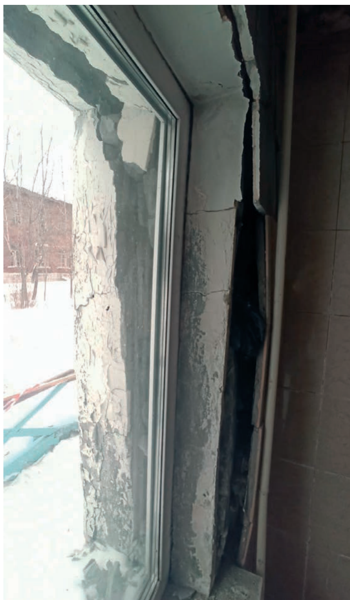
Рис. 3.18. Характерные дефекты наружных стеновых панелей общежития по адресу Советская, 176, к. 19/2
